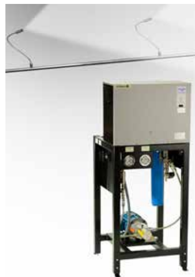
Vysokotlakový systém DriSteem poskytuje odparovacie chladenie a zvlhčovanie do viacerých priestorov vo vzduchotechnických zariadeniach, potrubíach a otvorených priestoroch. Riadiaca jednotka Vapor-logic poskytuje komplexnú správu všetkých systémových premenných.
