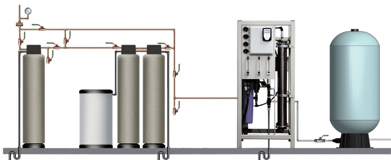
DriSteem-system med avklorinator, vattenavhärdare, system för omvänd osmos och lagringstank.
