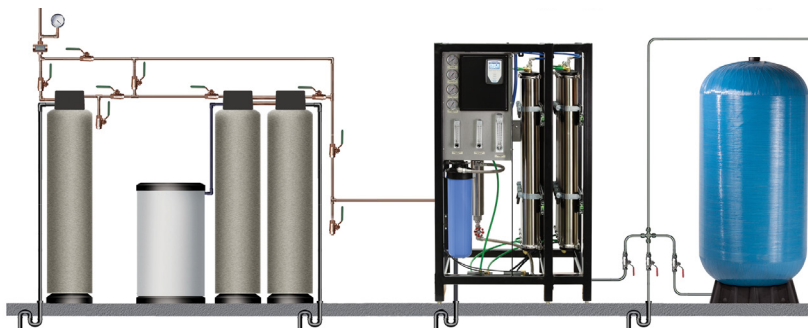
Systém DriSteem s dechlorátorom, zmäkčovačom vody, systémom reverznej osmózy a zásobníkom.
